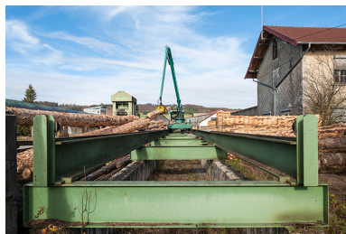
Chariot sur rail du poste d'écorçage. Phot. Jérôme Mongreville IVR43_20152502392NUC4A
