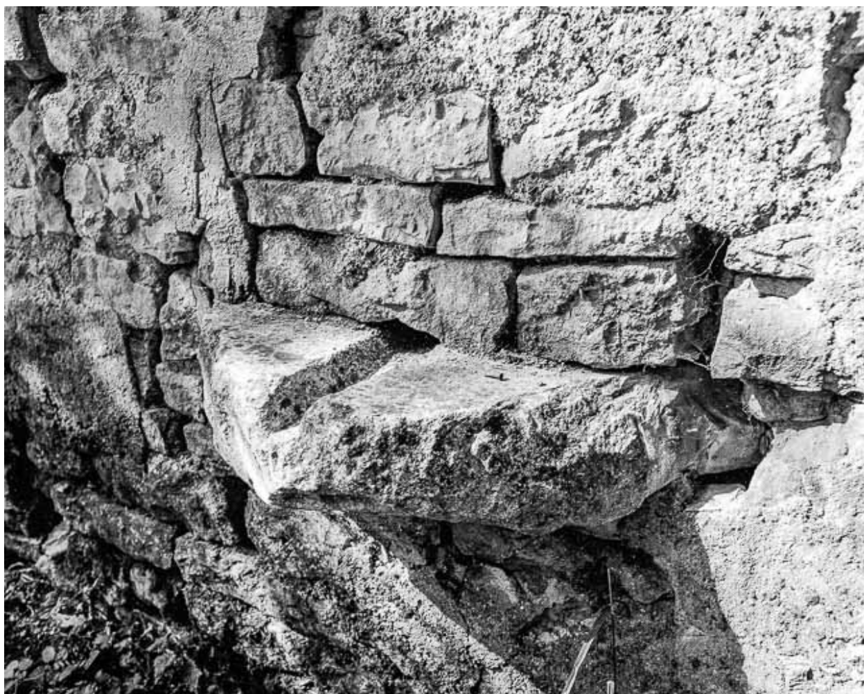
Maison située rue de Montbozon : pierre à évier sur la façade antérieure.
