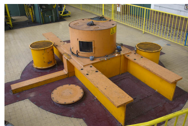
Partie supérieure de la turbine n°3. Phot. Yves Sancey IVR43_20122501942NUC2A
