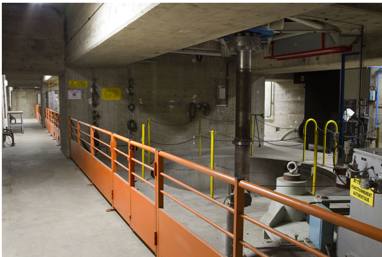
Etage inférieur de la salle des machines.
