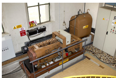
Groupe électrogène de secours (commande du vannage). Phot. Yves Sancey IVR43_20122501946NUC2A
