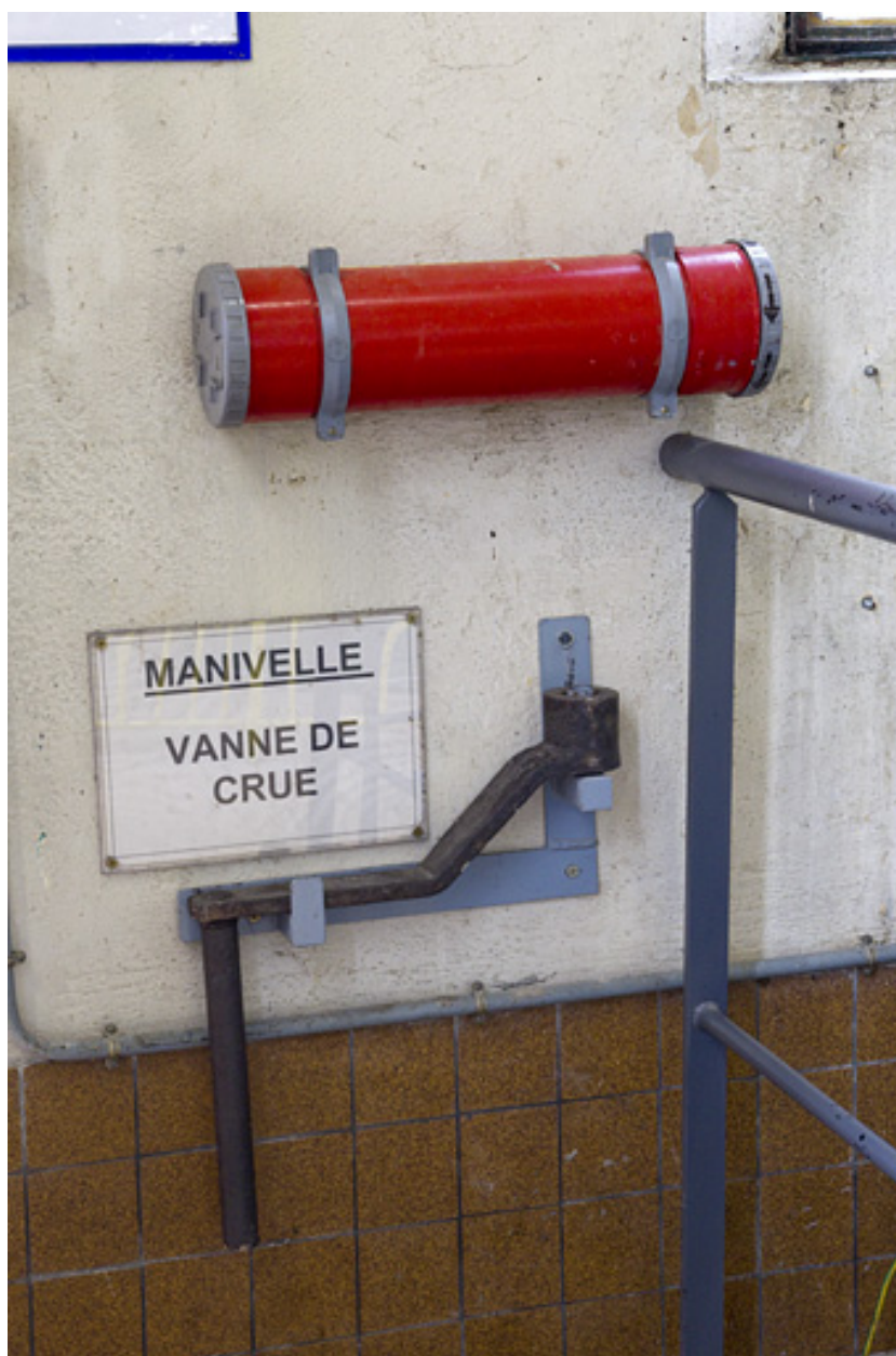
Manivelle de secours (commande du vannage).
