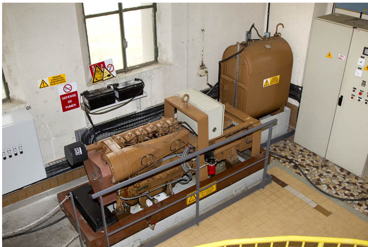
Groupe électrogène de secours (commande du vannage).
