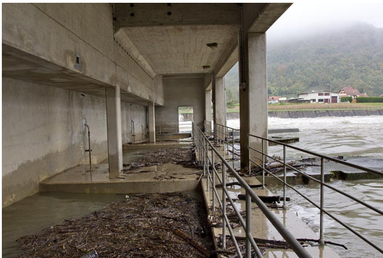
Partie inférieure de la salle des commandes.
