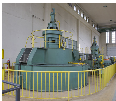
Groupes turbo-alternateurs. Vue rapprochée. Phot. Yves Sancey IVR43_20122501931NUC2A
