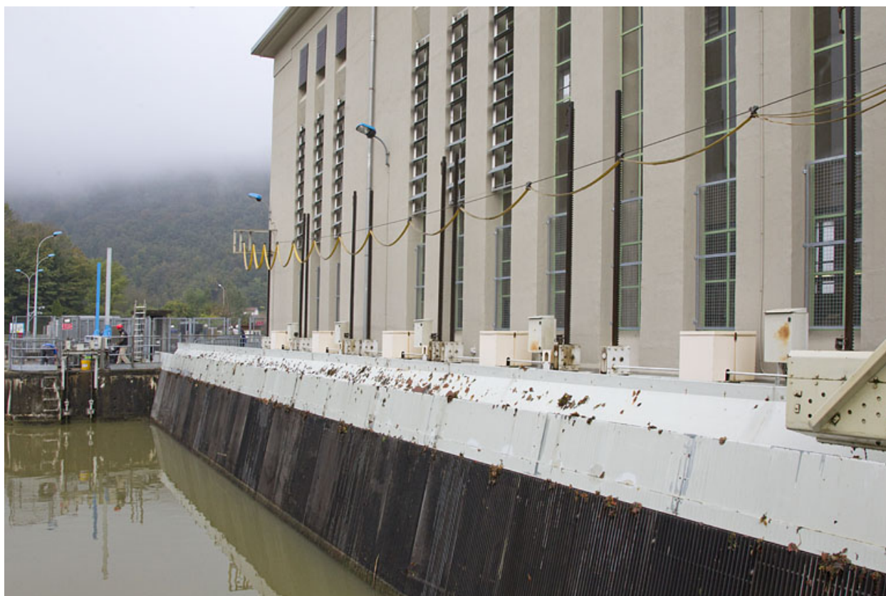
Grille d'admission de la centrale.
