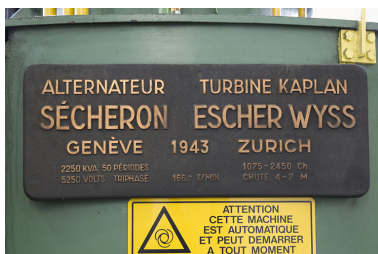
Plaque de constructeur du groupe. Phot. Yves Sancey IVR43_20122501943NUC2A
