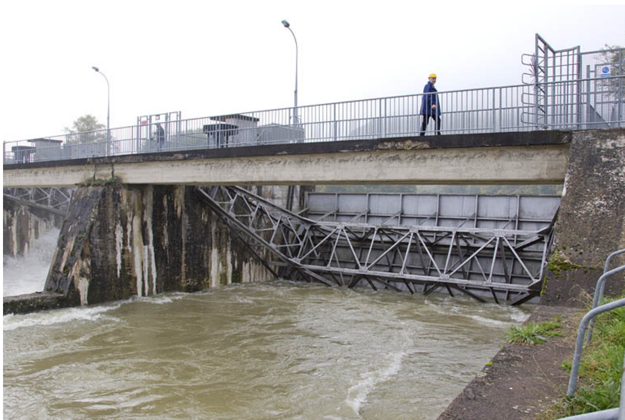
Vanne segment depuis l'aval.
