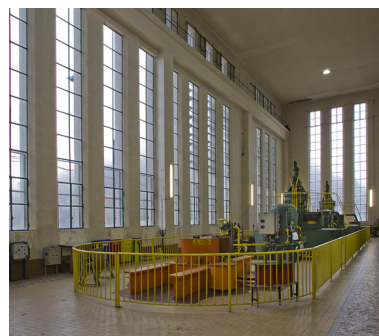
Vue d'ensemble de la salle des machines. Phot. Yves Sancey IVR43_20122501932NUC2A
