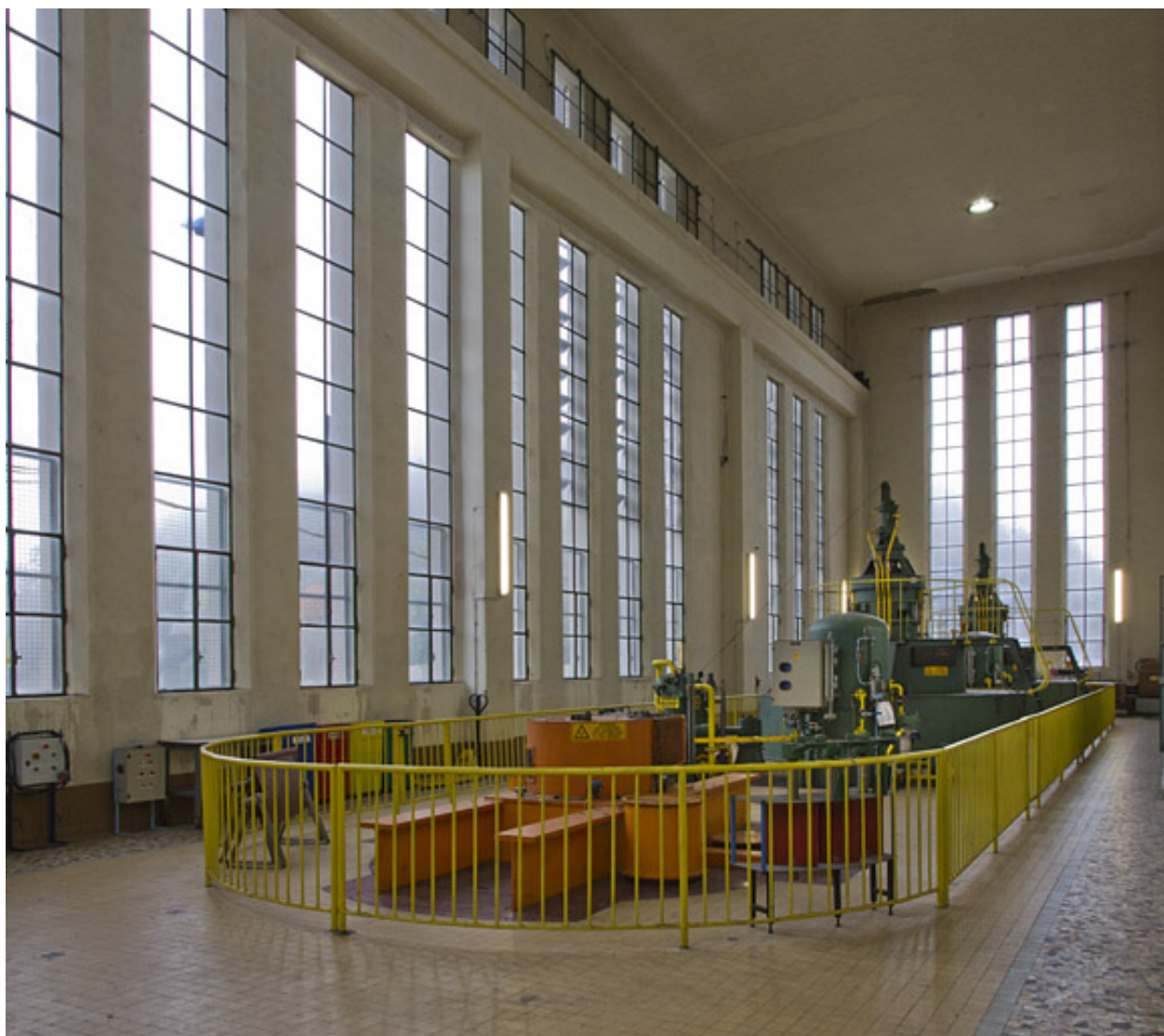
Vue d'ensemble de la salle des machines.
