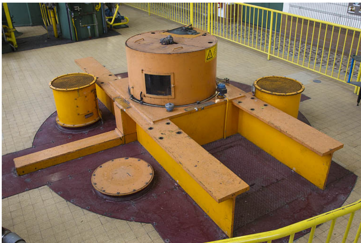
Partie supérieure de la turbine n°3.
