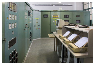
Salle des commandes. Phot. Yves Sancey IVR43_20122501949NUC2A
