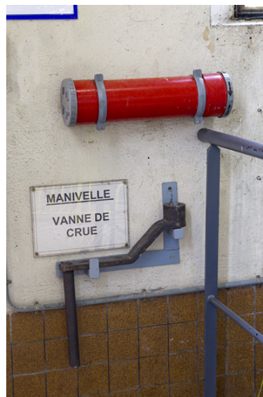
Manivelle de secours (commande du vannage). Phot. Yves Sancey IVR43_20122501950NUC2A
