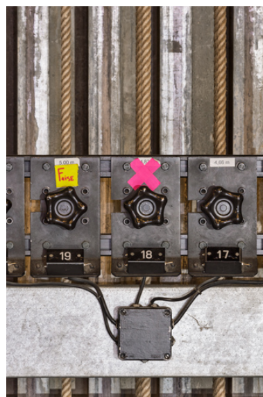
Maison de la culture, grande salle : détail de commandes de perches, au bas de la cheminée de contrepoids. Phot. Pierre-Marie Barbe-Richaud IVR26_20245800908NUC4A
