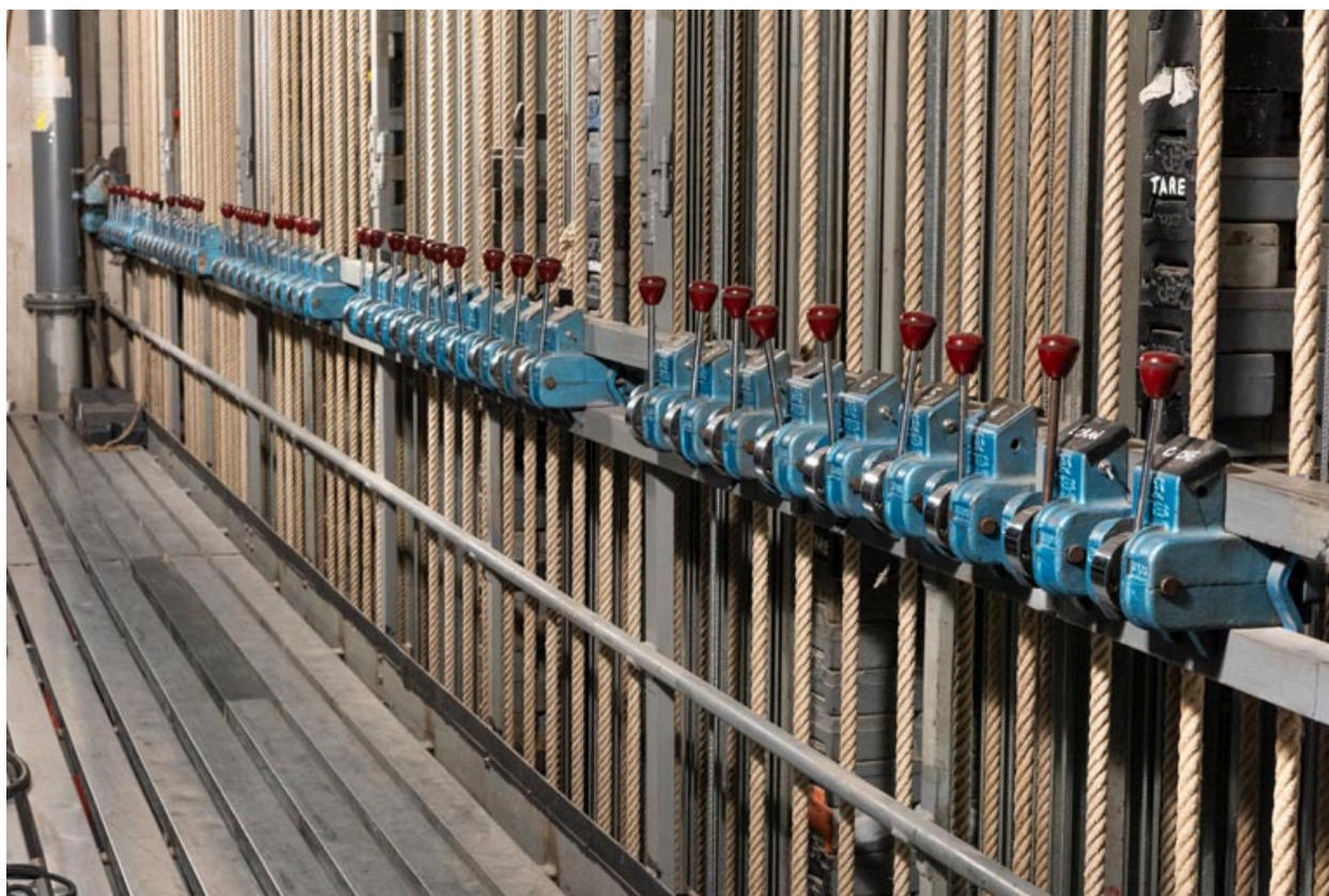
Maison de la culture, grande salle : freins à levier des équipes contrebalancées, sur la passerelle de commande (vue rapprochée).
