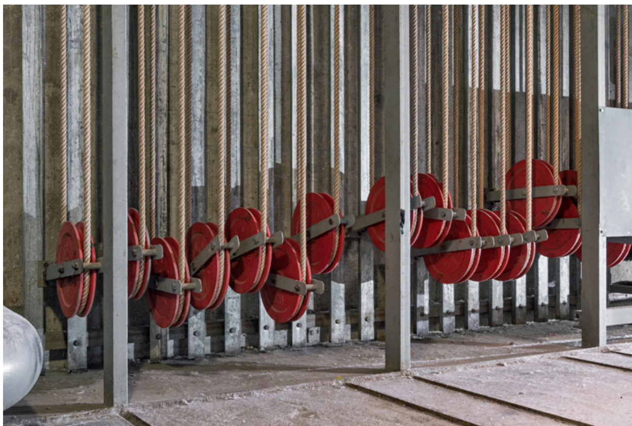
Maison de la culture, grande salle : poupées de retour des équipes contrebalancées, au dessous de scène.
