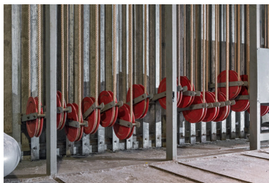
Maison de la culture, grande salle : poupées de retour des équipes contrebalancées, au dessous de scène. Phot. Pierre-Marie Barbe-Richaud IVR26_20245800933NUC4A
