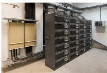
Maison de la culture : salle des gradateurs. Phot. Pierre-Marie Barbe-Richaud IVR26_20245800953NUC4A
