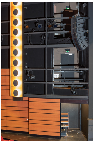
Maison de la culture, grande salle : rampe lumineuse et hauts-parleurs, côté cour. Phot. Pierre-Marie Barbe-Richaud IVR26_20245800925NUC4A
