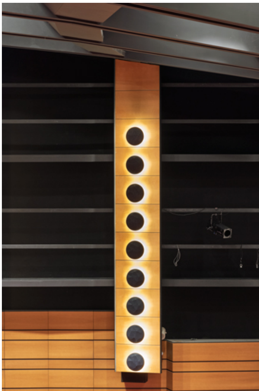
Maison de la culture, grande salle : rampe lumineuse.
