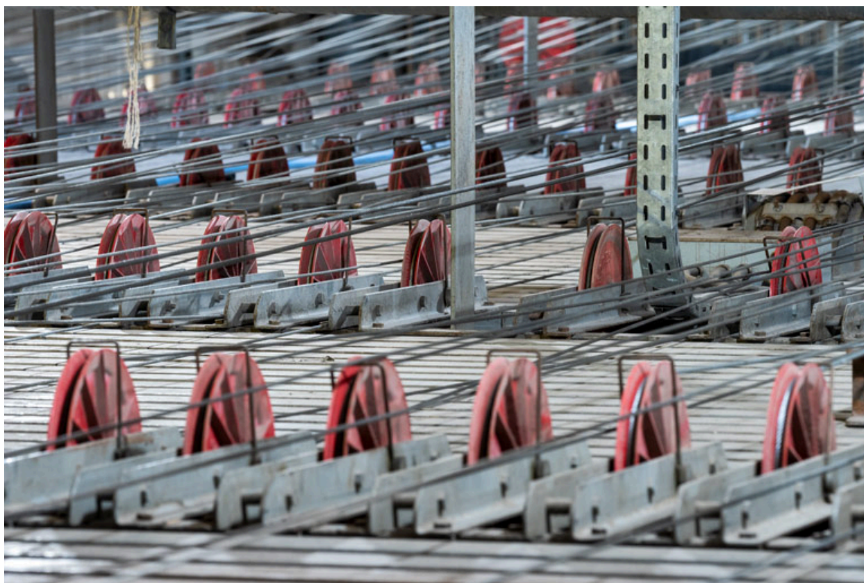
Maison de la culture, grande salle : poulies sur le le gril.
