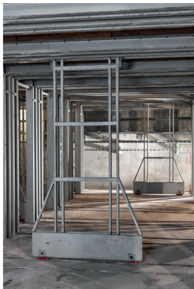
Maison de la culture, grande salle : chariots du dessous de scène. Phot. Pierre-Marie Barbe-Richaud IVR26_20245800932NUC4A
