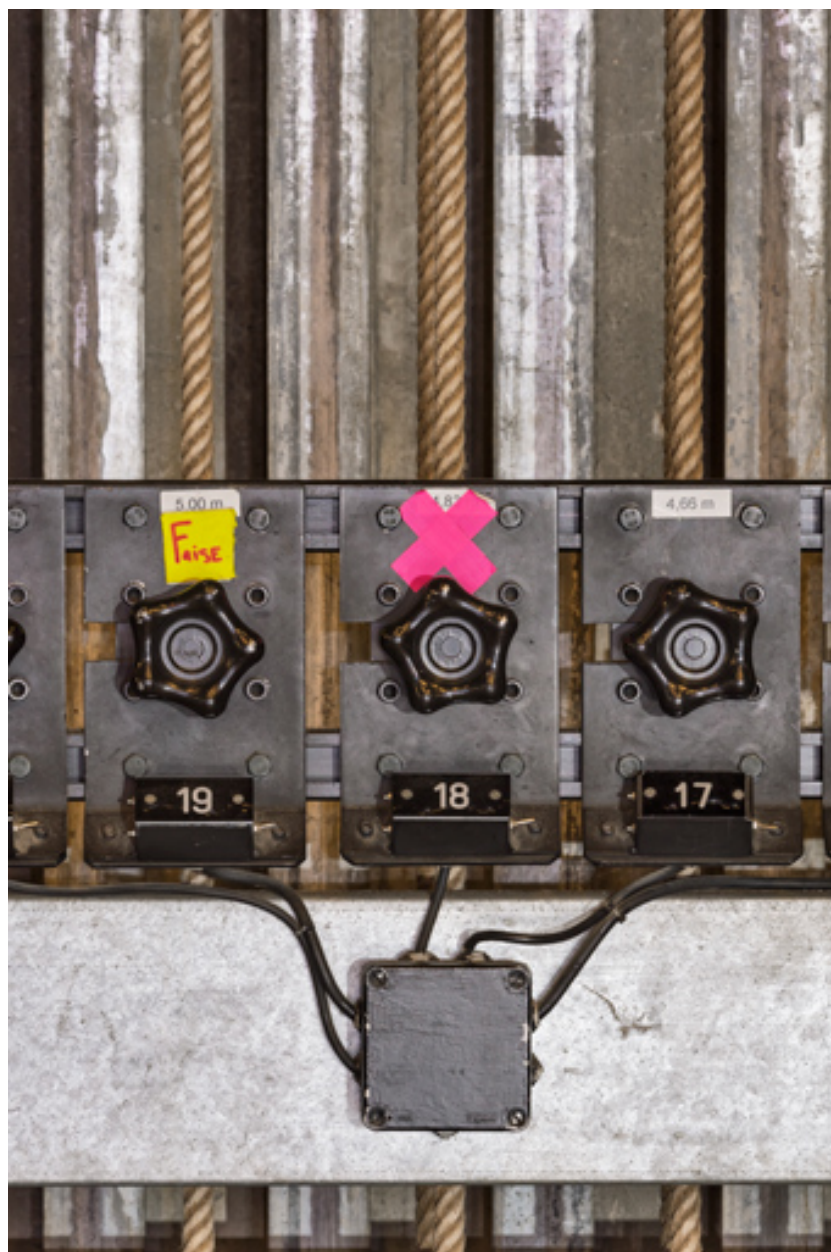
Maison de la culture, grande salle : détail de commandes de perches, au bas de la cheminée de contrepoids.
