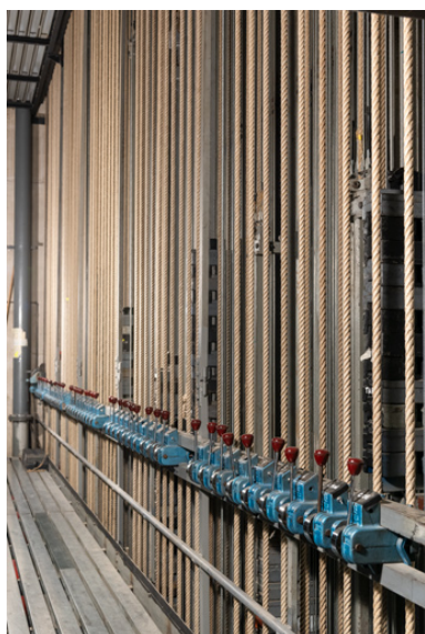
Maison de la culture, grande salle : freins à levier des équipes contrebalancées, sur la passerelle de commande. Phot. Pierre-Marie Barbe-Richaud IVR26_20245800940NUC4A
