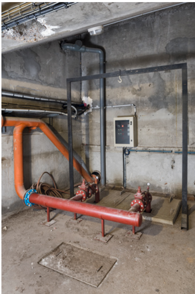
Maison des sports : pompe de relevage (étage de soubassement côté RN).
