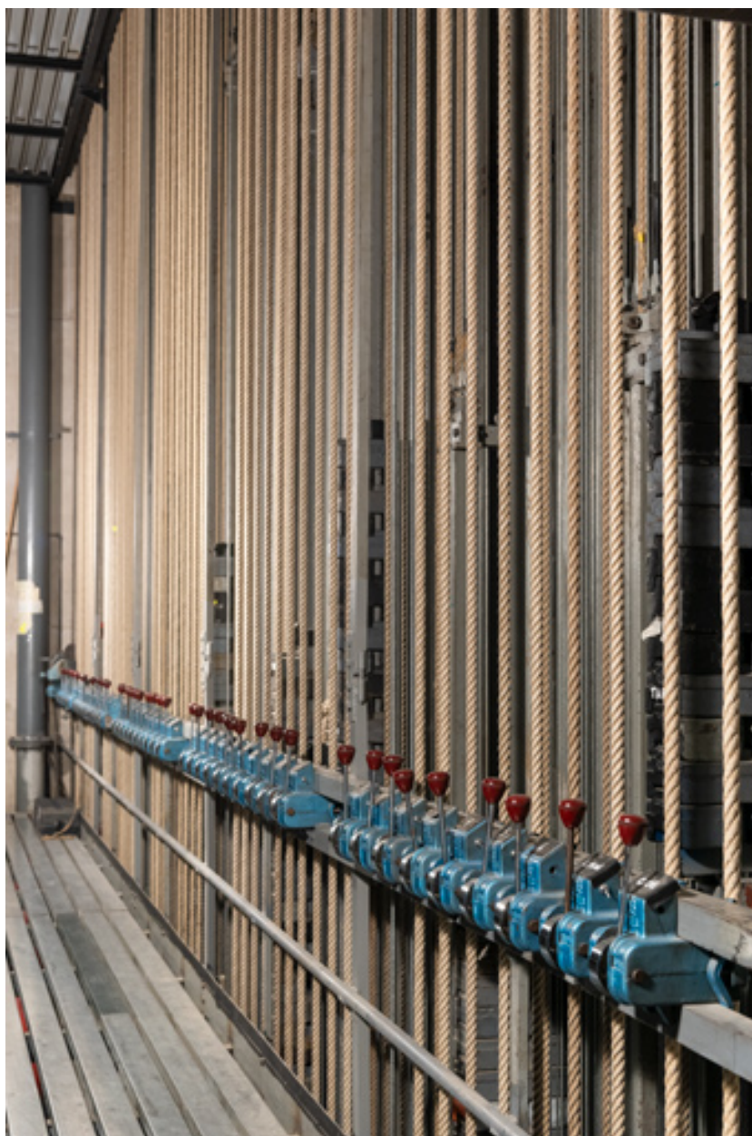
Maison de la culture, grande salle : freins à levier des équipes contrebalancées, sur la passerelle de commande.
