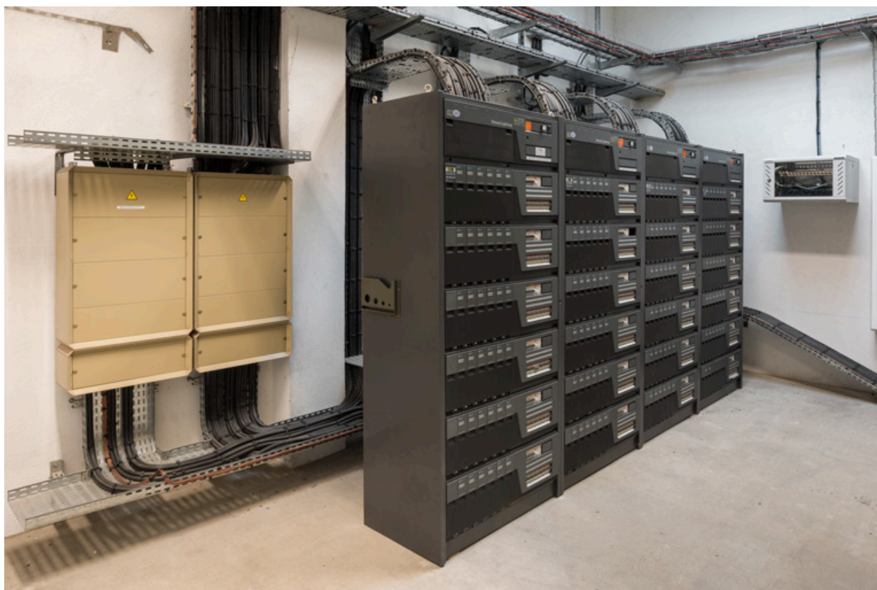
Maison de la culture : salle des gradateurs.
