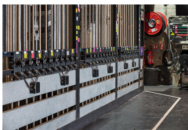
Maison de la culture, grande salle : commandes des perches, au bas de la cheminée de contrepoids. Phot. Pierre-Marie Barbe-Richaud IVR26_20245800907NUC4A
