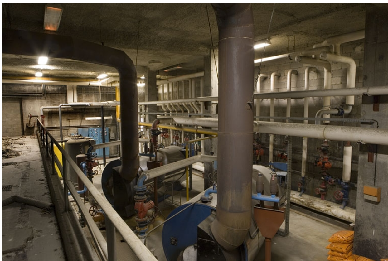
Bâtiment D. Sous-sol. Vue de la chaufferie.
