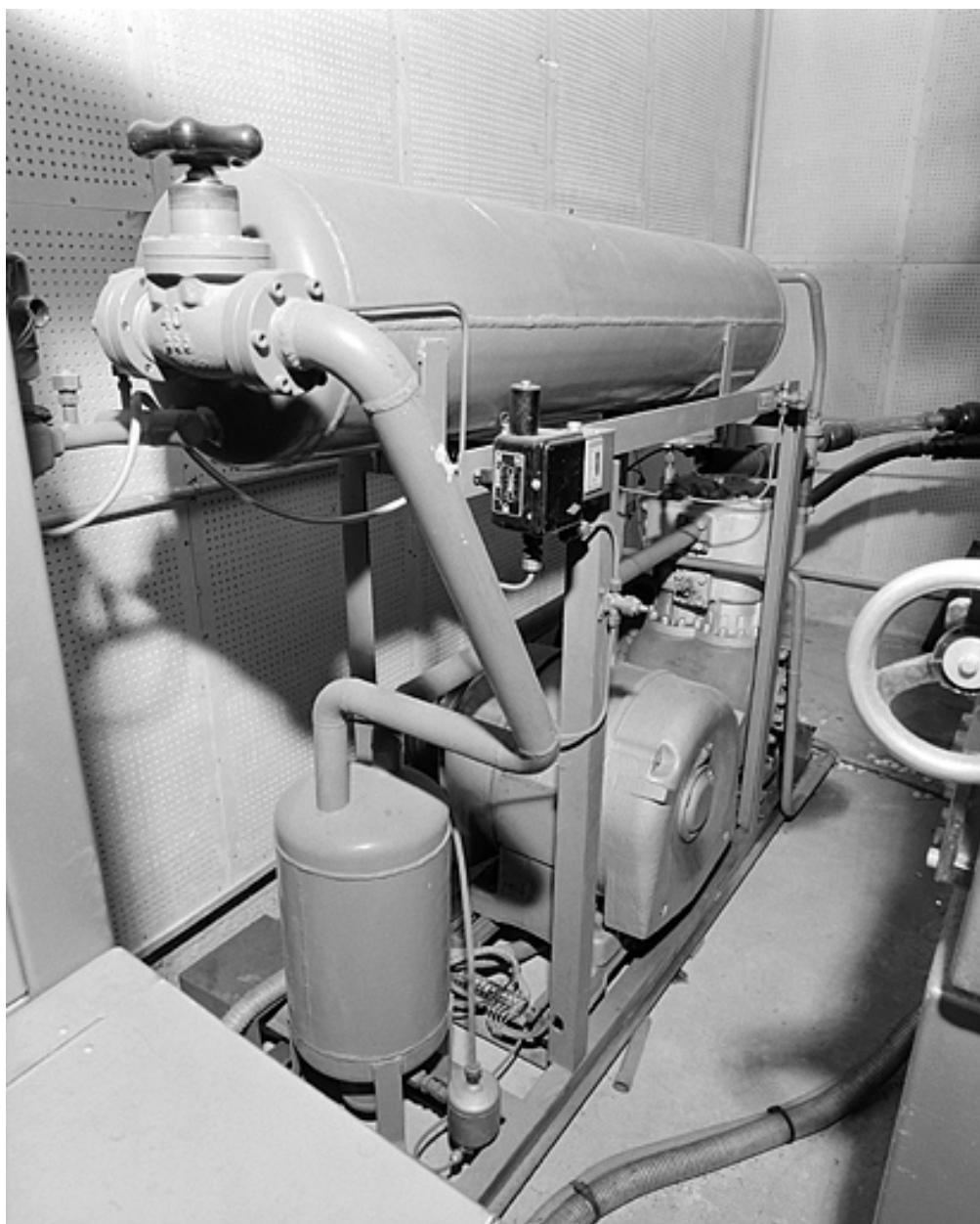
Groupe compresseur - pompe à vide.
