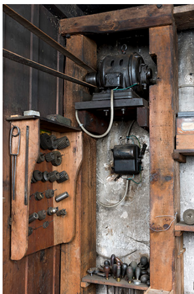
Vue d'ensemble du moteur électrique. Phot. Sonia Dourlot IVR43_20172500041NUC4A
