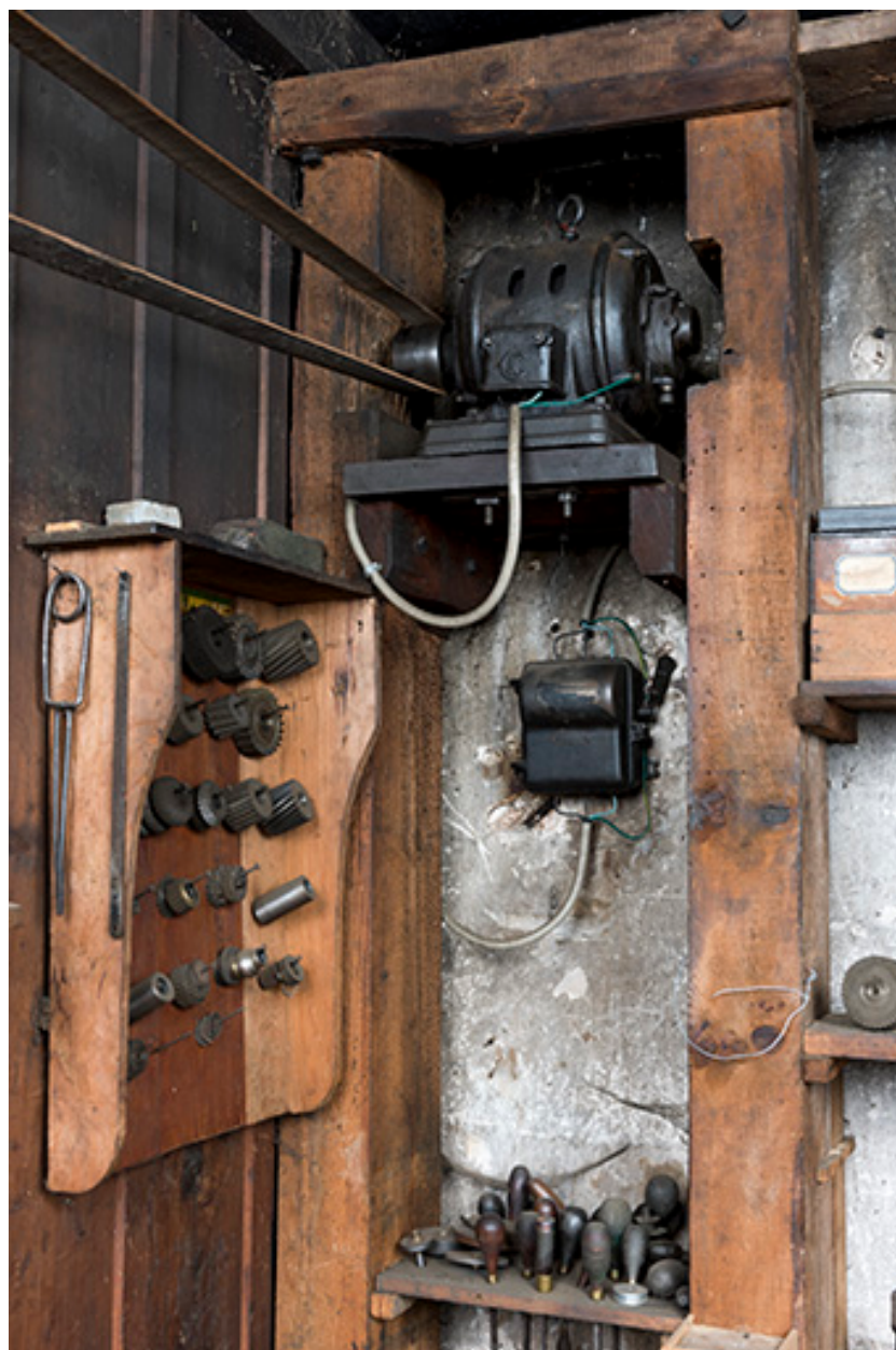
Vue d'ensemble du moteur électrique.
