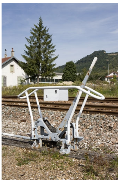
Levier de manoeuvre non enclenché. Phot. Yves Sancey IVR43_20083900908NUC2A
