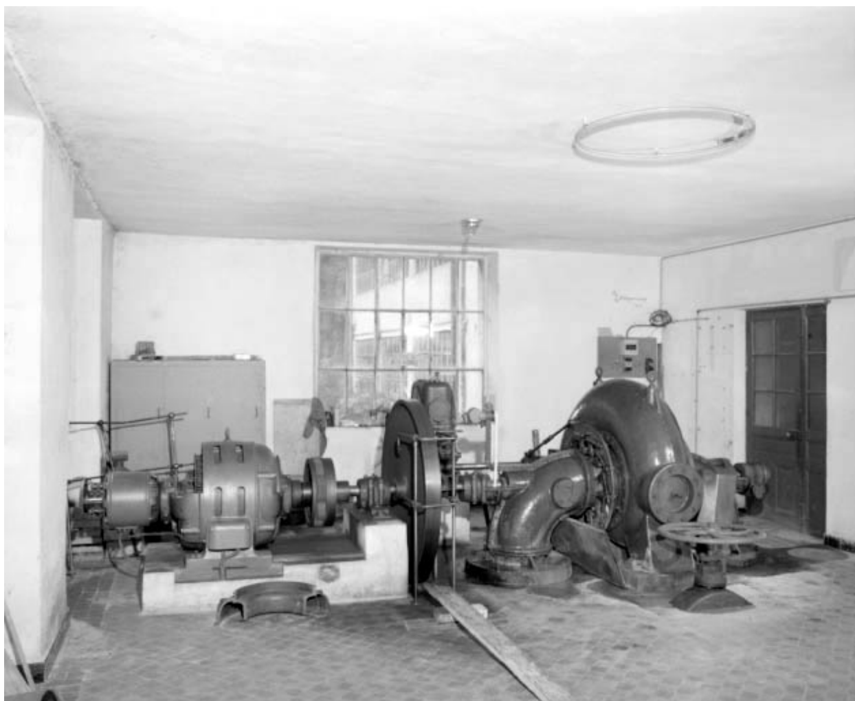
Centrale hydroélectrique : groupe récent.
