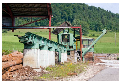
Parc aux grumes : écorceuse Segem. Phot. Yves Sancey IVR43_20132501285NUC2A
