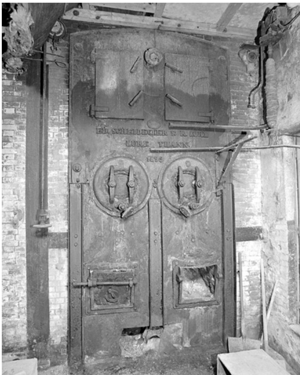
Chaudière de la machine à vapeur.
