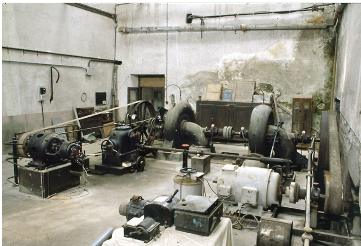
Les turbines du bâtiment d'eau.
