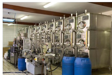
Chai. Batterie de cuves. Phot. Jérôme Mongreville IVR43_20077000236NUCA
