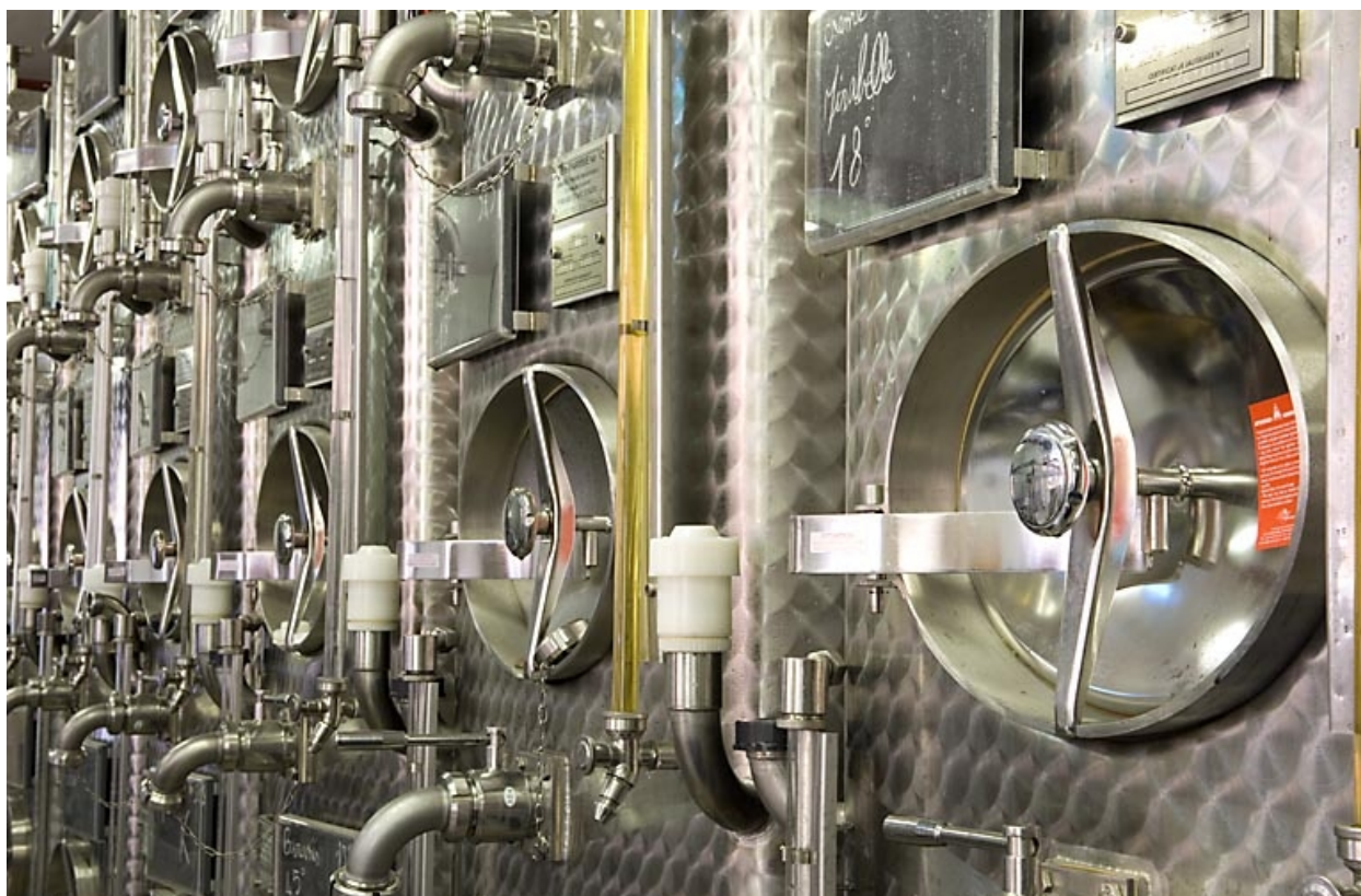
Chai. Détail des cuves.
