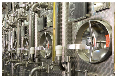
Chai. Détail des cuves. Phot. Jérôme Mongreville IVR43_20077000237NUCA
