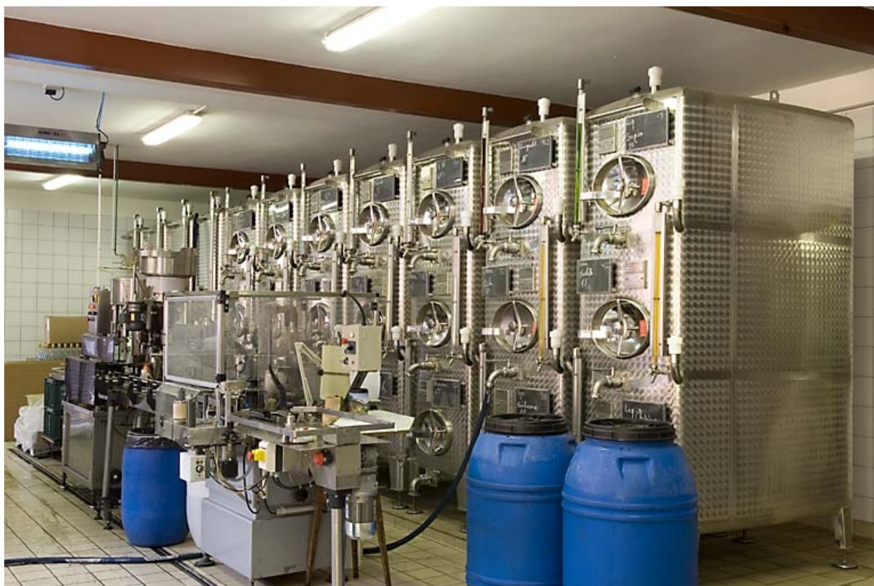
Chai. Batterie de cuves.
