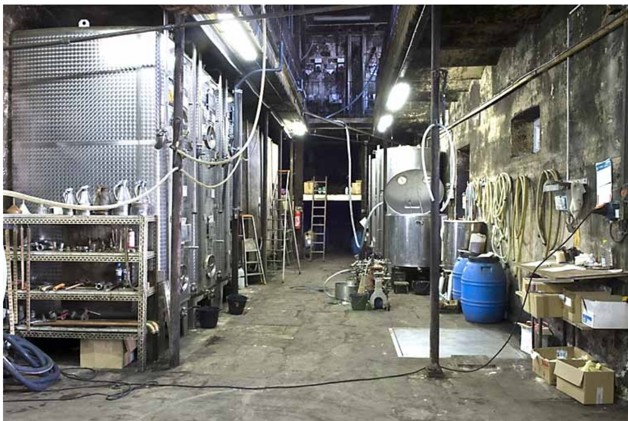
Cuverie. Installations récentes.
