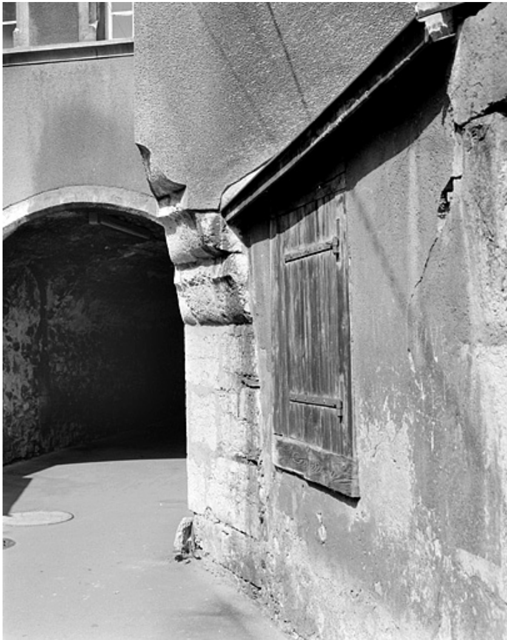
Surplomb de la tour d'escalier.
