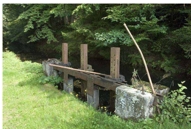
Vanne de décharge sur le bief d'aménée.
