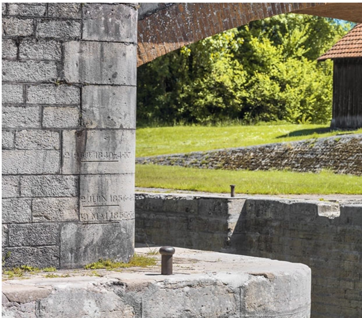
Détail de l'échelle de crue.
