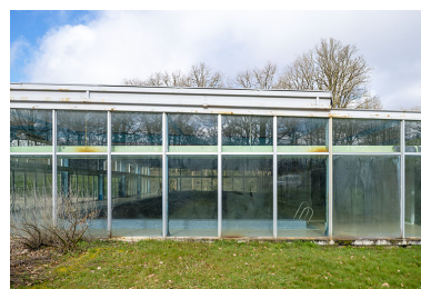
Détail de la façade sud- est, à l'avant du bassin. Phot. Aline Thomas IVR43_20267000048NUC4A
