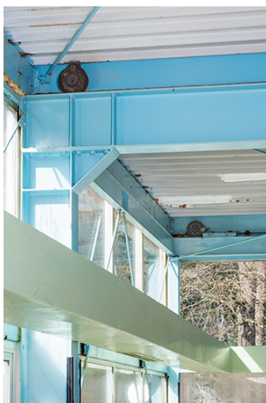
Gaine d'aération et système poteau-poutre couvrant le bassin. Phot. Nicolas Waltefaugle IVR43_20267000020NUC4A
