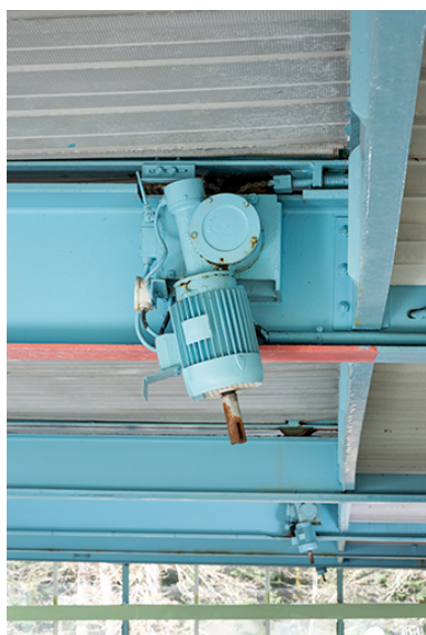
L'un des moteurs ouvrant le toit. Phot. Nicolas Waltefaugle IVR43_20267000018NUC4A
