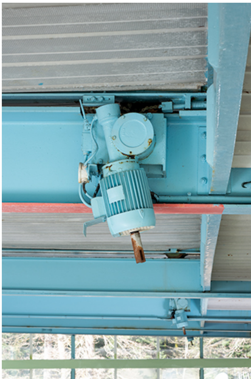
L'un des moteurs ouvrant le toit.
