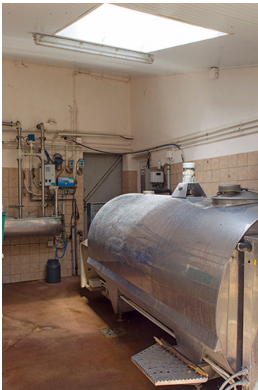
Tank à lait dans l'étable ouest.
