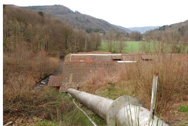
Conduite forcée de la centrale hydroélectrique. Phot. Jérôme Mongreville IVR43_20057000177NUCA
