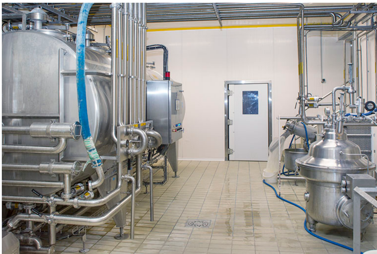
Salle de la station de lavage CIP.
