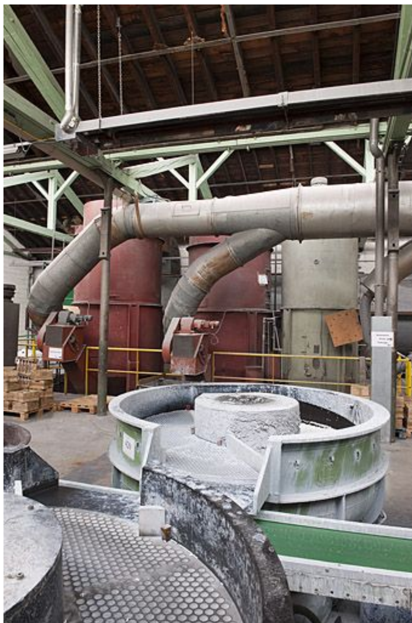
Atelier de polissage et chambre d'aspiration.
