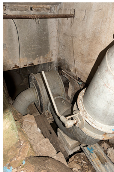
Derrière le Mont : moulin et scierie Chardon. La turbine. Phot. Sonia Dourlot IVR43_20172501778NUC4A
