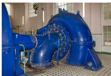
Groupe n° 1 : bâche de la turbine. Phot. Yves Sancey IVR43_20122502124NUC2A
