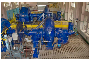
Groupe n° 2 : bache de la turbine. Phot. Yves Sancey IVR43_20122502123NUC2A
