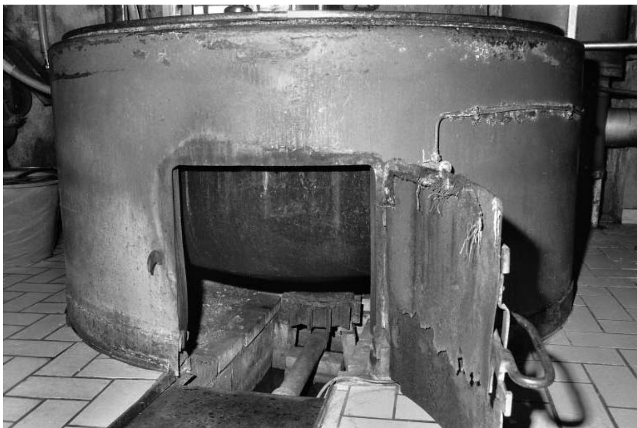
Cuve : brûleur au gaz.
