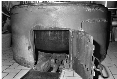
Cuve : brûleur au gaz. Phot. Laurent Poupard IVR43_19903900548Z
