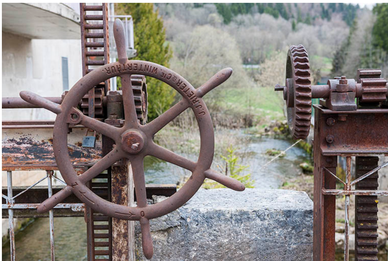
Détail du mécanisme du vannage.
