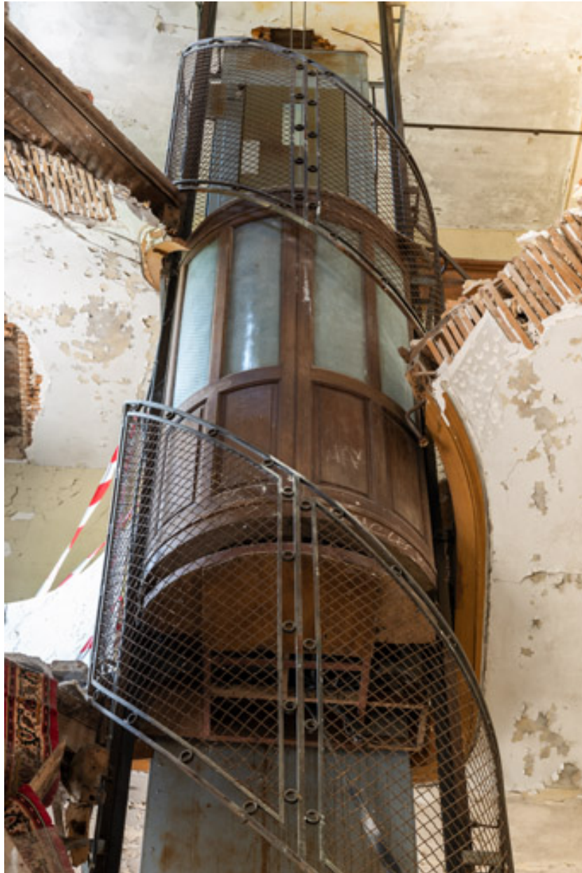
Ascenseur de l'escalier ouest, cabine.
