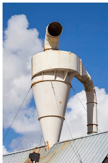
Silo à sciure (L) : cyclone.
