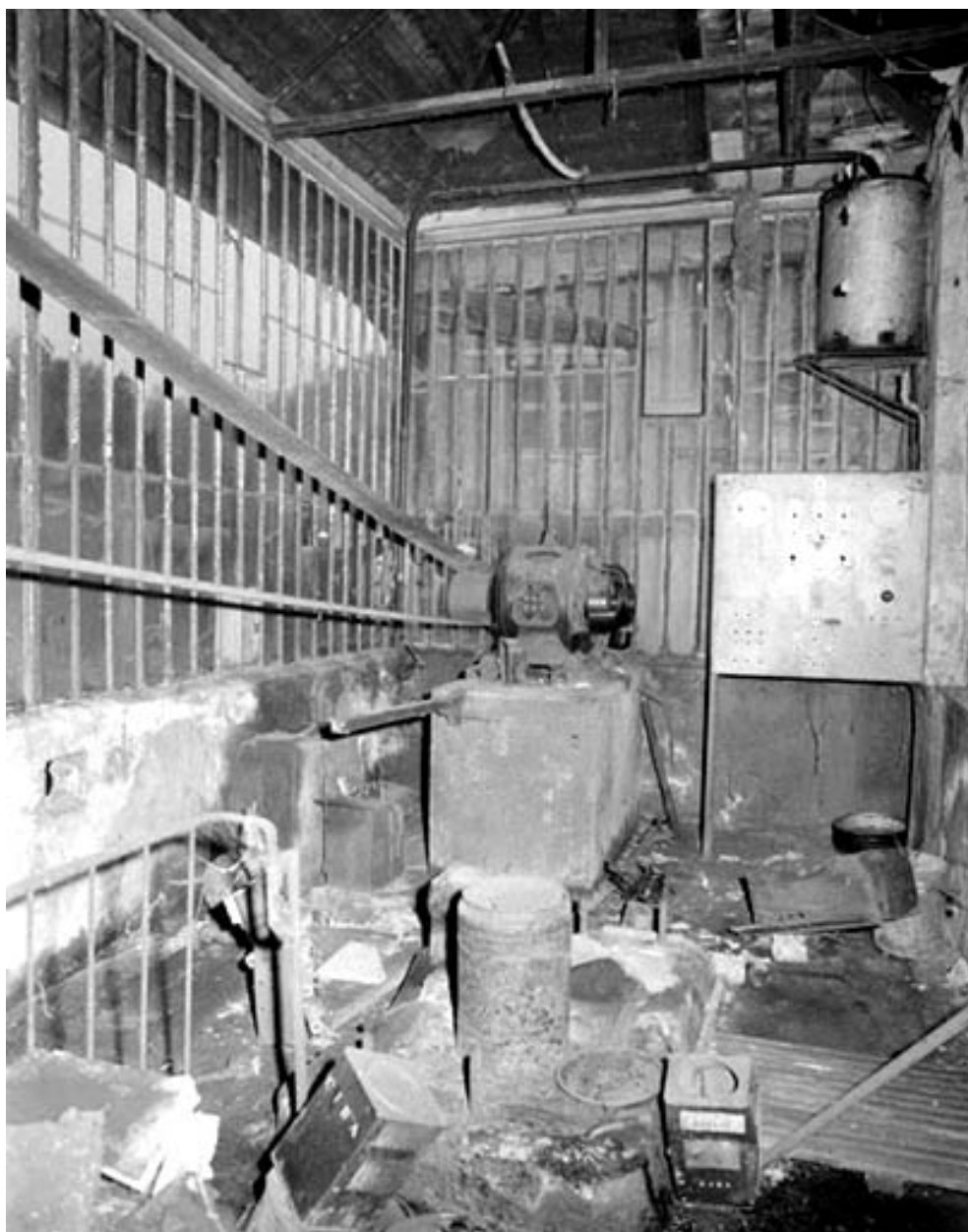
Moteur électrique Patay.
