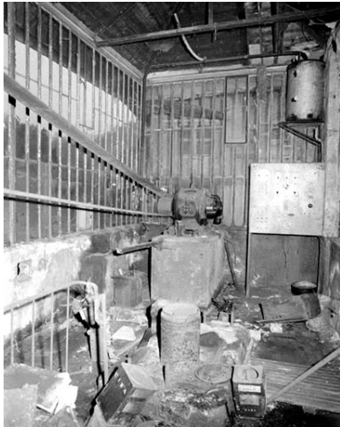
Moteur électrique Patay. Phot. Yves Sancey IVR43_19943901565X
