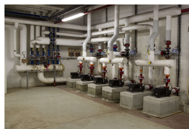
Bâtiment de l'internat ouest, chaufferie : les pompes. Phot. Yves Sancey IVR43_20122500744NUC2A
