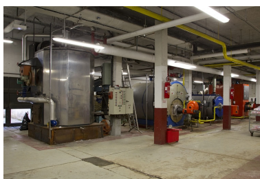
Bâtiment de l'internat ouest, chaufferie : les chaudières. Phot. Yves Sancey IVR43_20122500745NUC2A
