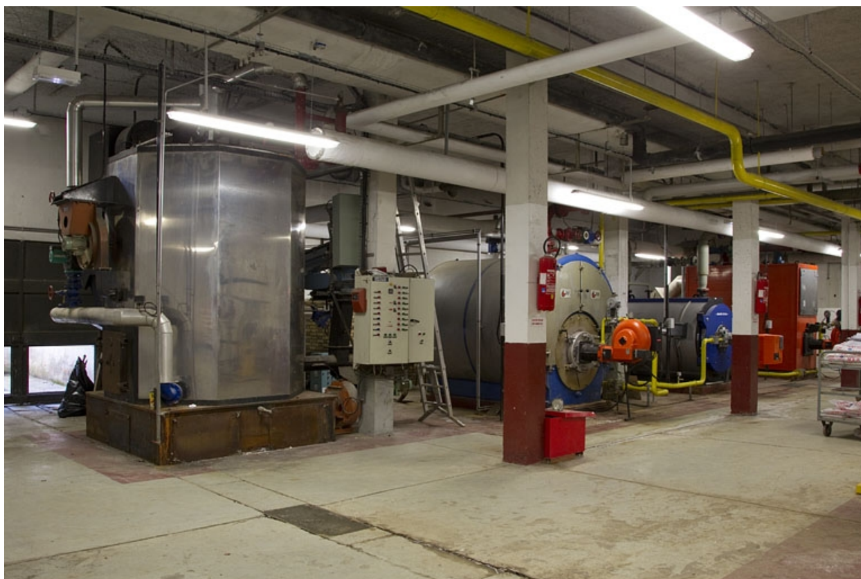
Bâtiment de l'internat ouest, chaufferie : les chaudières.
