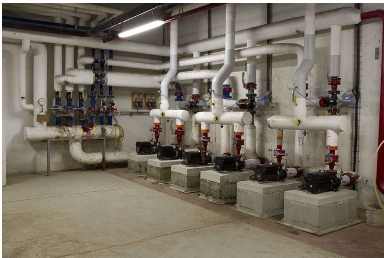
Bâtiment de l'internat ouest, chaufferie : les pompes.
