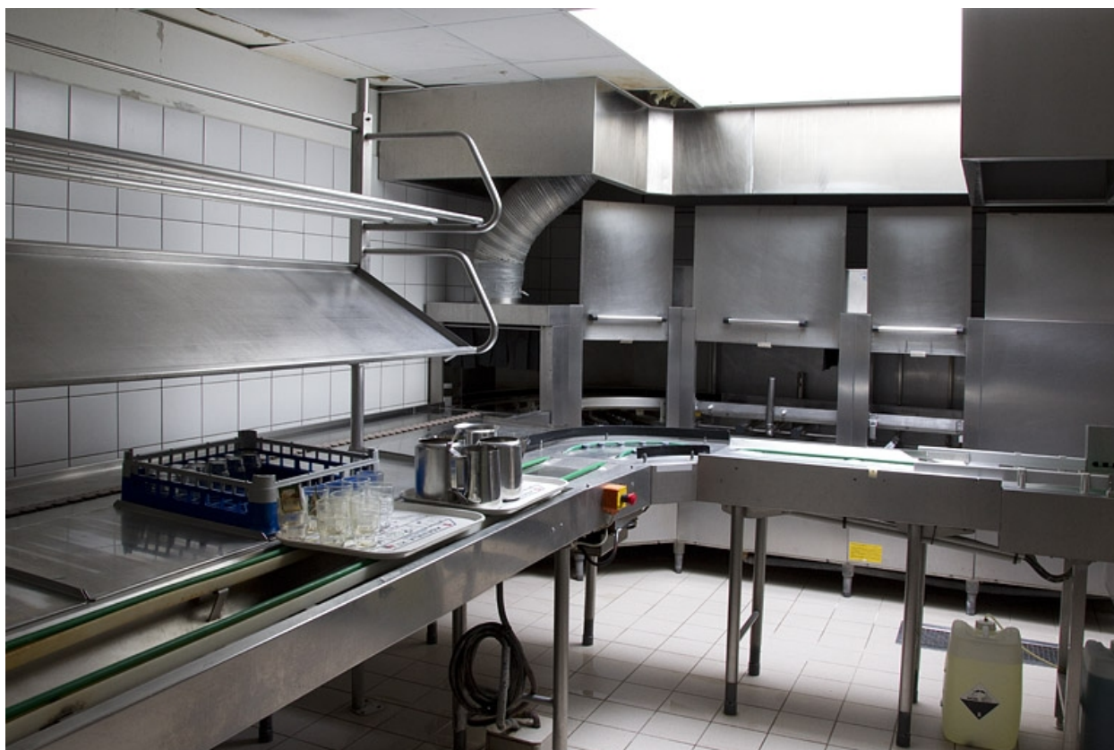
Restauration : convoyeur de la plonge.
