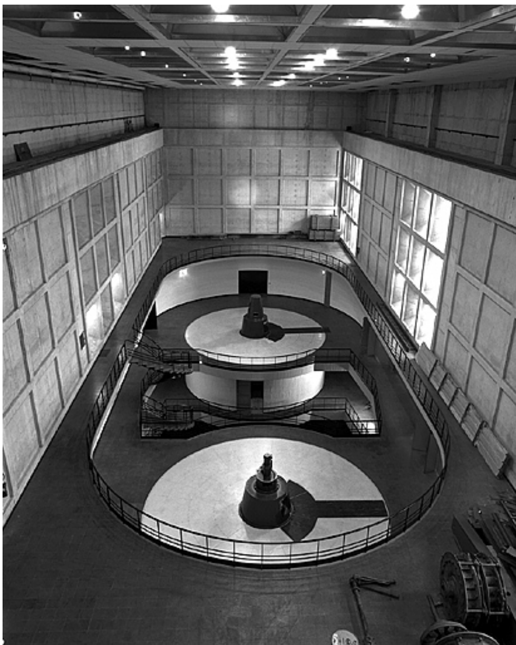
Intérieur de la centrale.
